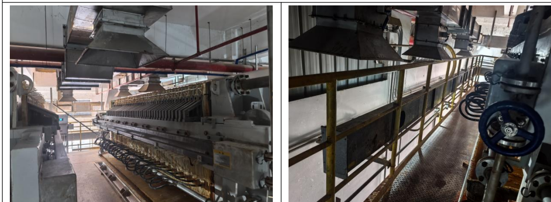
SBM 板框压滤区废气集气罩（以新带老措施）
