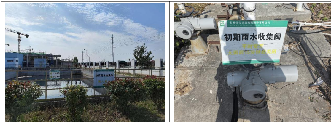
初期雨水池及切换阀
