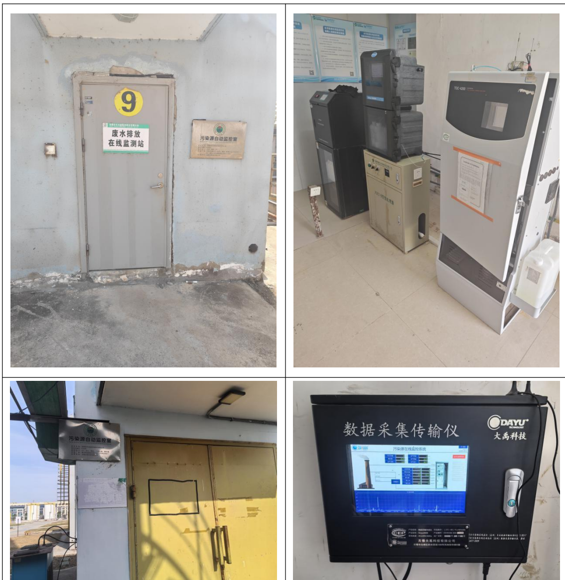
废水、废气在线监测设备及站房
