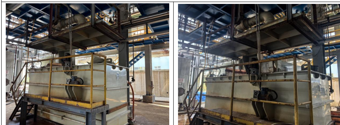
盐回收浮选槽上方集气罩（以新带老措施）
