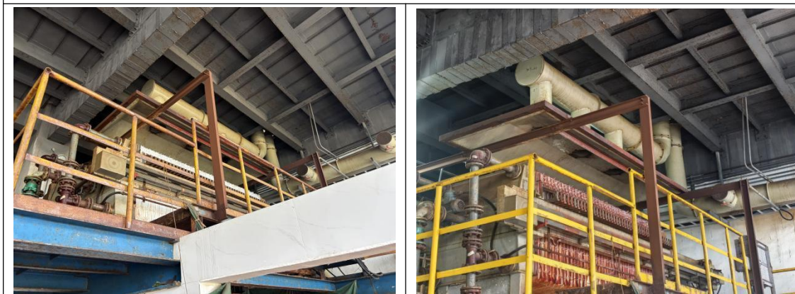
苯甲酸回收装置上方集气罩（以新带老措施）
