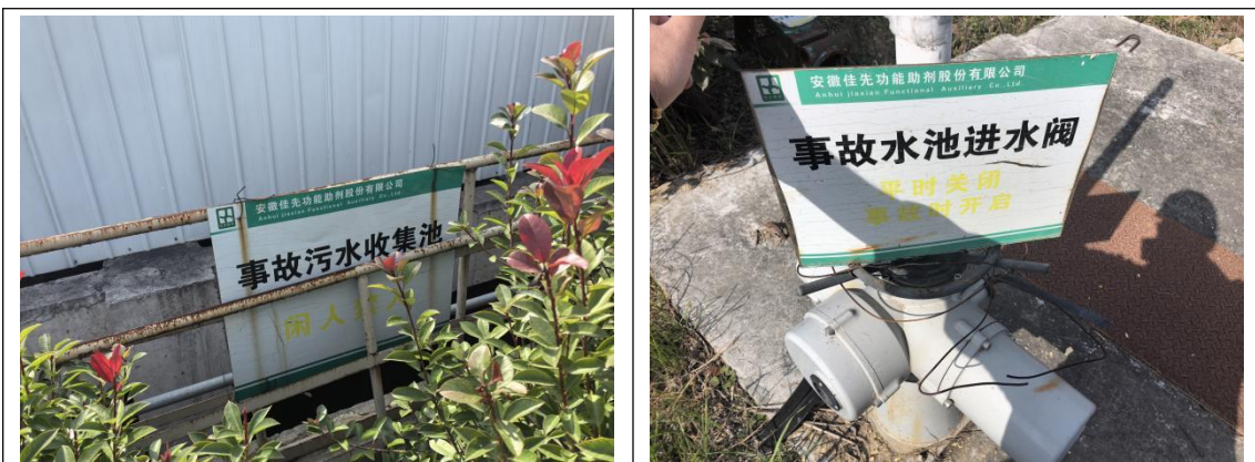
事故池及切换阀
