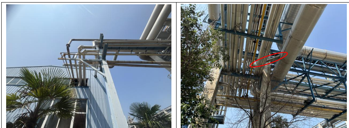
危废库废液储罐废气管道（以新带老措施）
